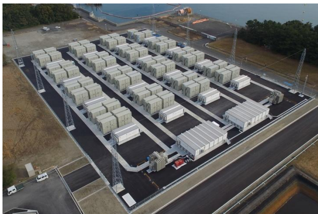
Système de stockage d'énergie à grande échelle dans la centrale électrique de Buzen de Kyushu Electric Power
