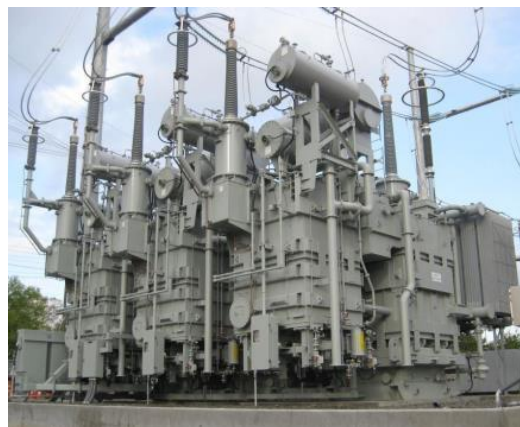
Transformateur triphasé distinct
